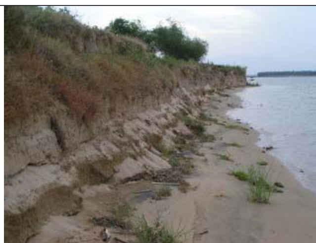
Hình 3: Xói lở bờ sông đoạn qua xã Điện Phong (Quảng Nam)
